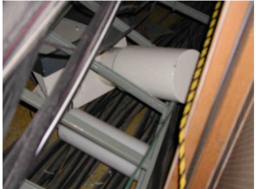
エリアモニター破損
