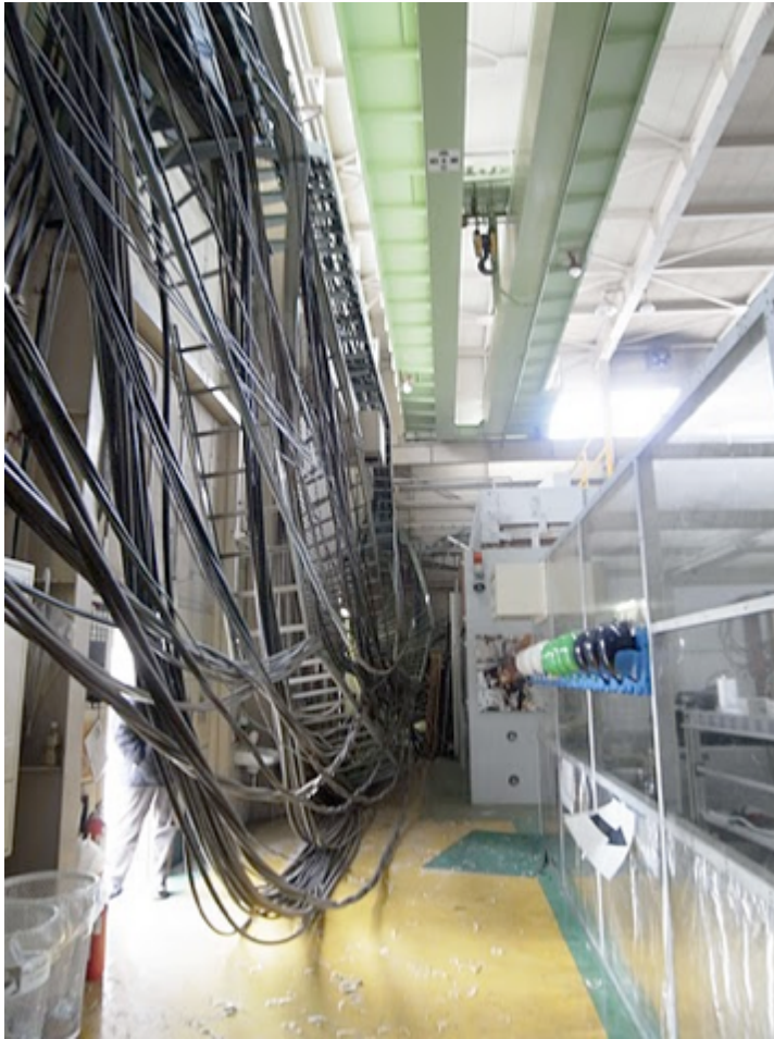
変電施設(S-360)電源ケーブルラック崩落(420V, 他)
