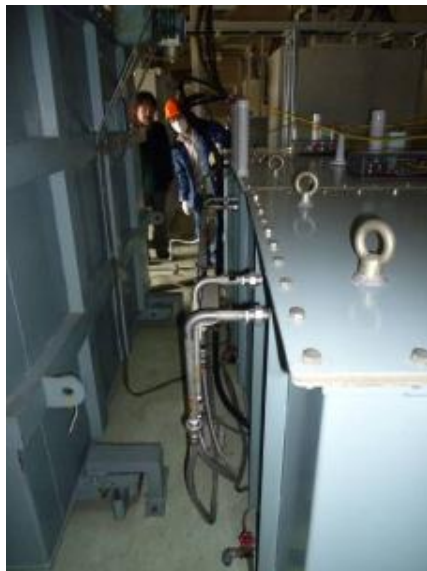
旧型高圧電源の位置ずれ、水漏れ
