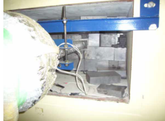
壁貫通管周囲に積んであった鉛ブロックが一部崩落
