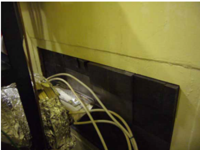
壁貫通管の周囲に積んであった鉛ブロックがずれて壁からはみ出た
