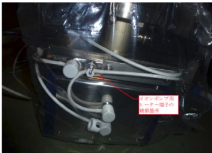
AR南棟にて、イオンポンプが転倒により破損。
