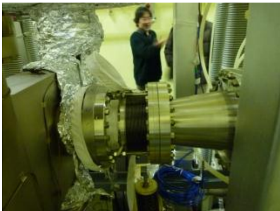
空洞セクションのベローズ管変形
