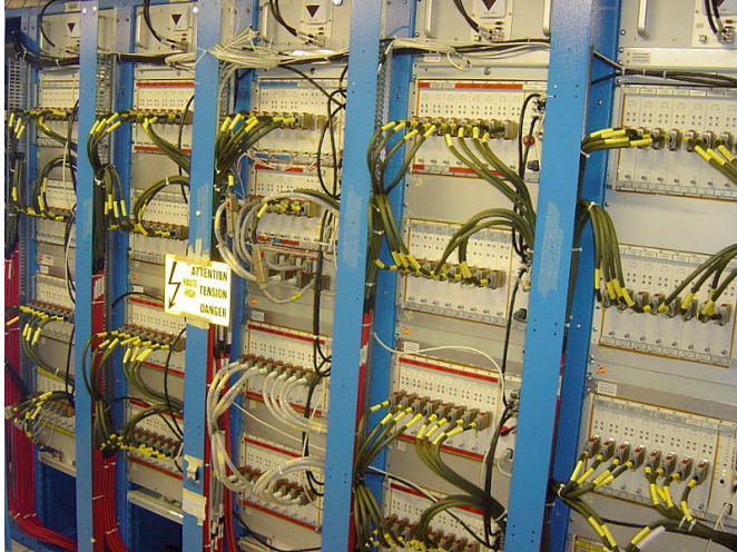
Système haute tension
