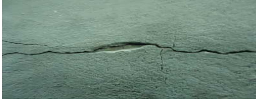
Fissure sur le béton d'un fût turbine de la centrale hydroélectrique INGA II
