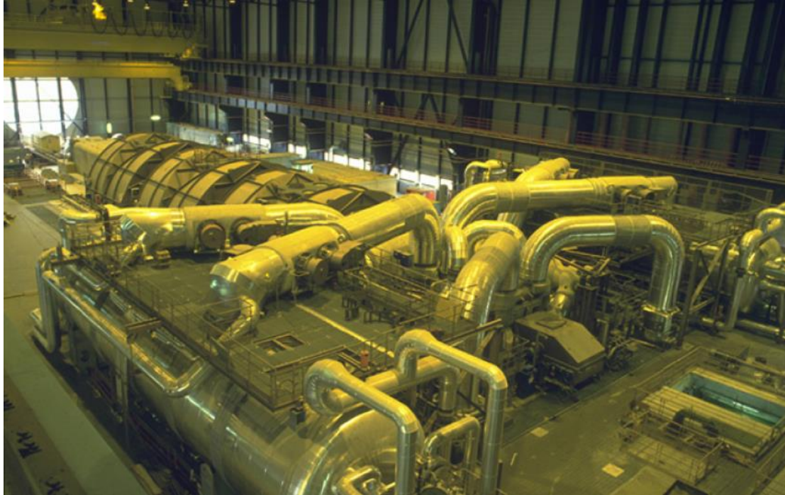
Salle des machines de la centrale nucléaire de Chooz (France). Copyright AREVA/E. Joly.
