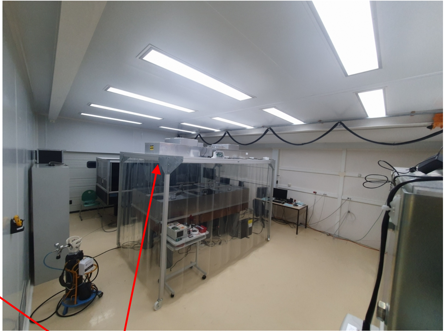
Plafonds soufflant (ISO 5/6 dessous)
