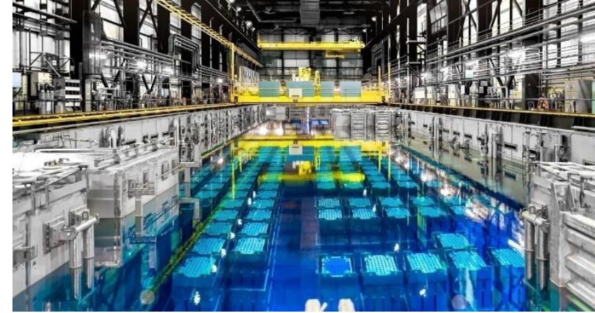
Entreposage des CU en piscine
