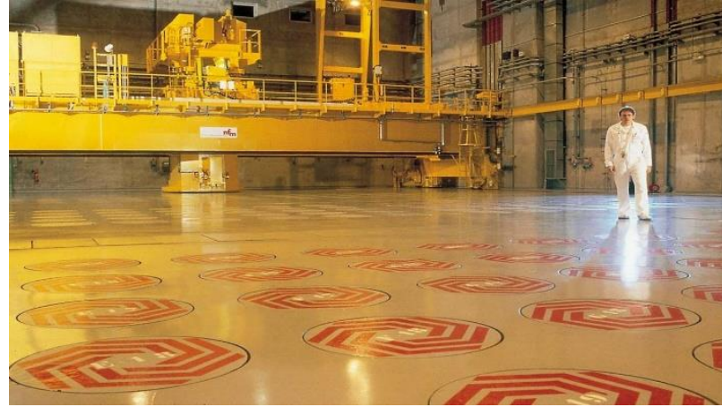
Entreposage des CSD dans des puits
