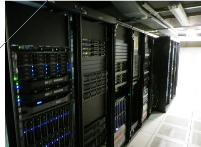
Salle serveurs Computing room
