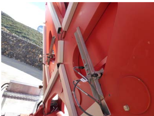
Nouveau design des chemins de câbles
