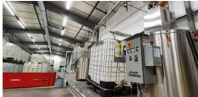
Evaporateur Déchets liquides aqueux
