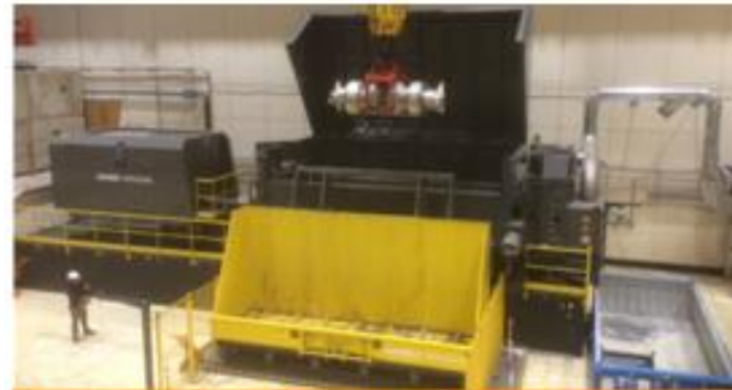
Presse-cisaille (600 tonnes) Réduction de volume Déchets métalliques
