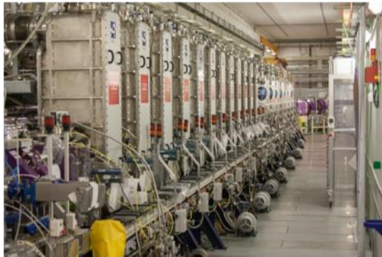
ACCÉLÉRATEUR LINÉAIRE (LINAC)
