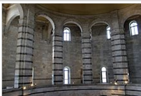
Arc doubleau tombant sur une fenêtre rebouchée.
