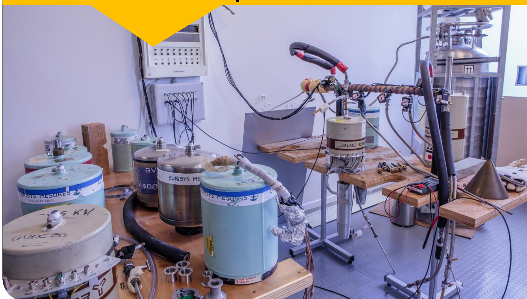
Salle avec système de mise en froid en azote liquide à 7 voies
